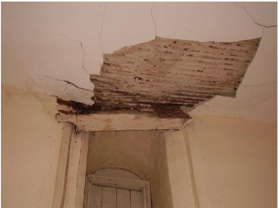
Griūnančios bažnyčios lubos ties varpinės bokštu 2008 m.
